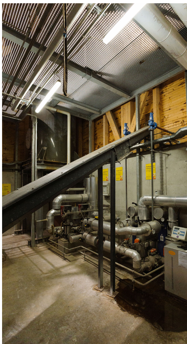
Feinaschenaustragung, im Hintergrund Netzpumpen Lismi
