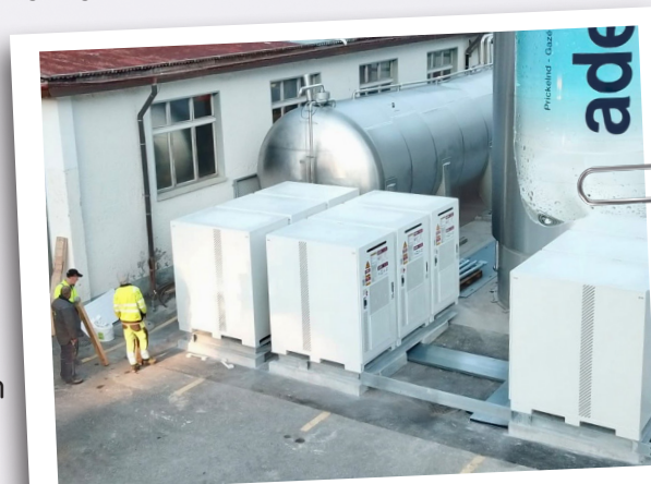
OEY: ERSTER BATTERIESPEICHER IN BETRIEB.
